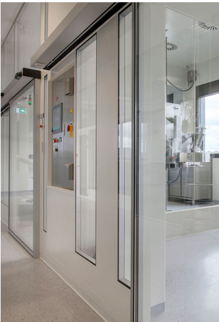
Abb. 2: Reinraumgerechte Türeinbauten. (Bild: Glatt)
